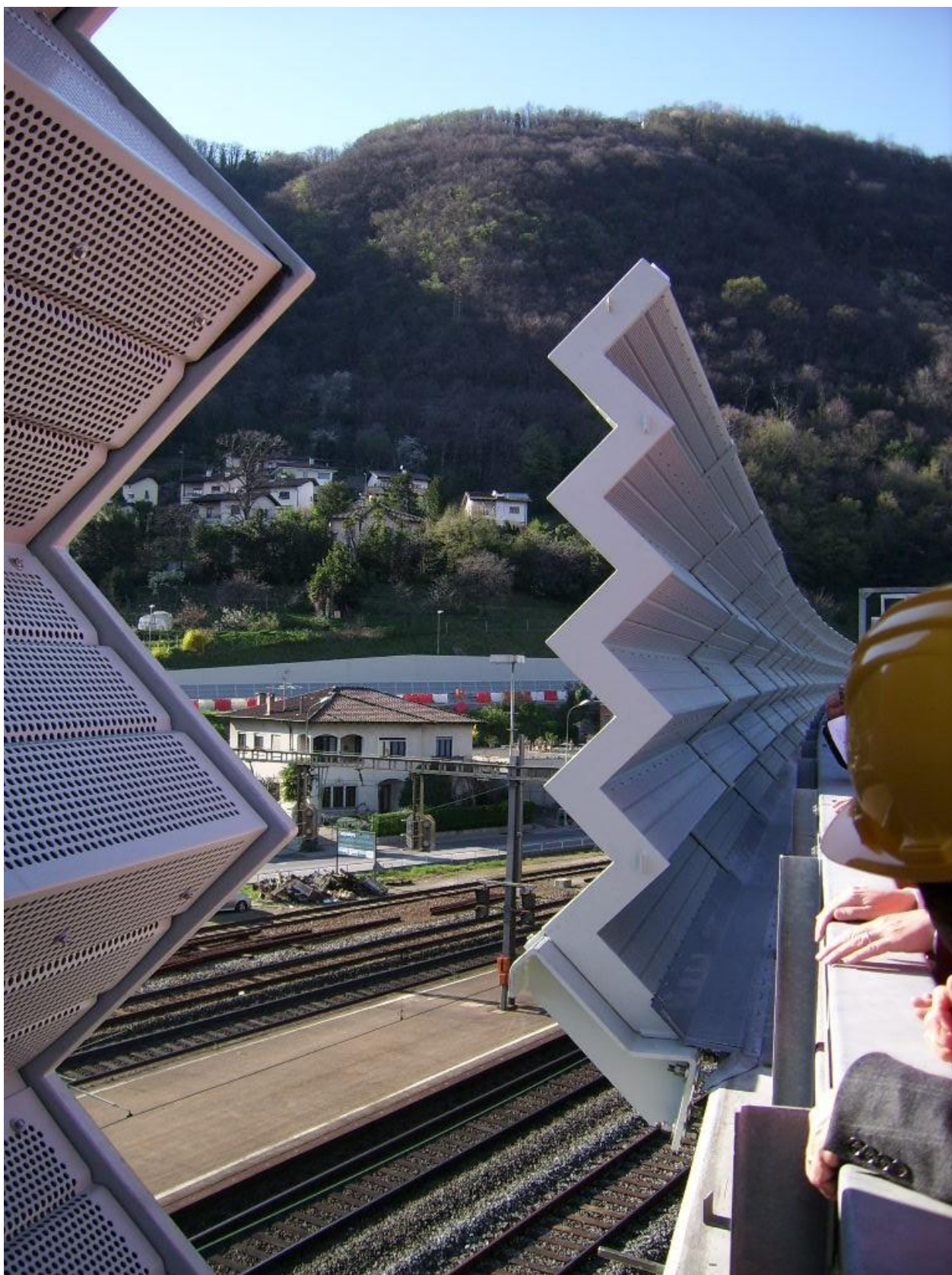
Protihluková stěna na dálnici E35 procházející kolem jezera Lago du Lugano - Melide
